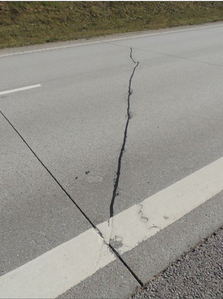
Murdunud betoonplaat, mille praod on täidetud pehme mastiksi-ga, Uppsala. (Foto: Ain Kendra)
