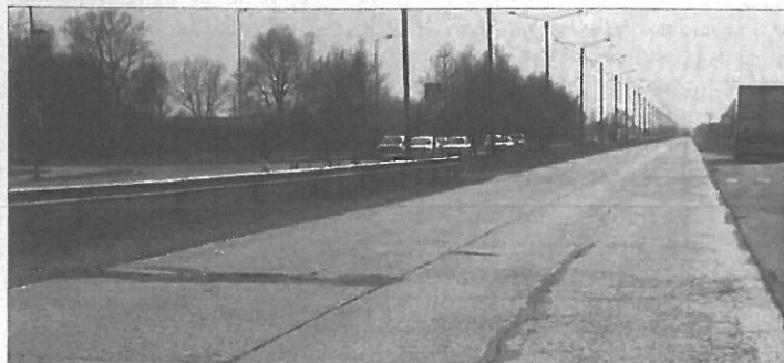
TÄNASENI vastu pidanud betoonkatendiga teelõik Peterburi maanteel Väos. Vasakul sõidurajal on näha kunagi üles kerkinud ja asfaldiga parandatud koht.
